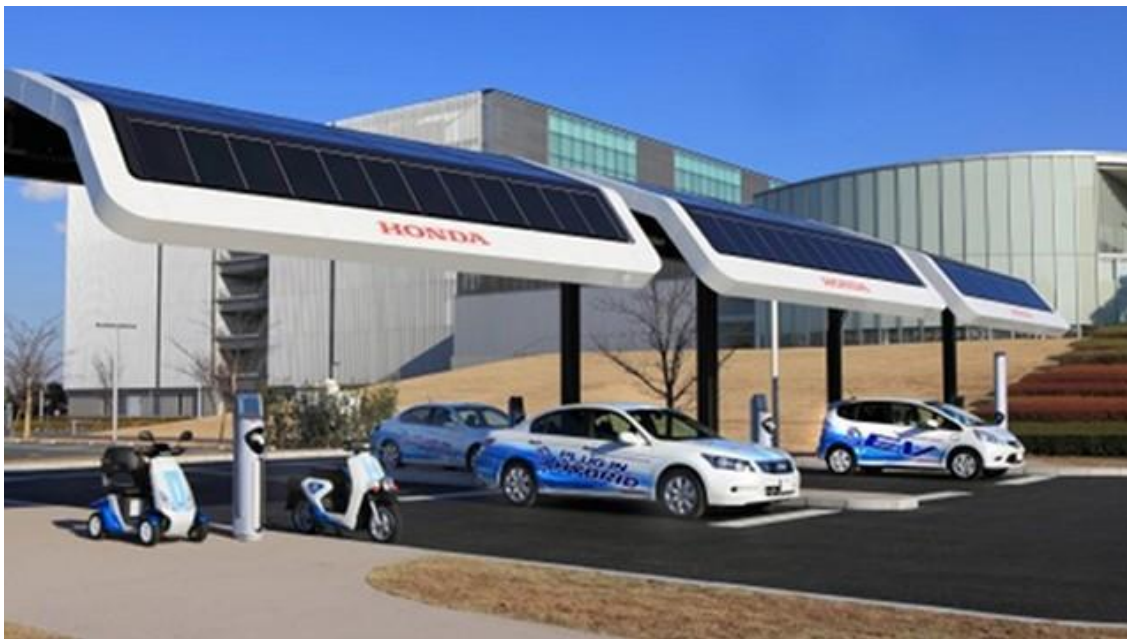
Une station solaire de recharge de véhicules électriques
